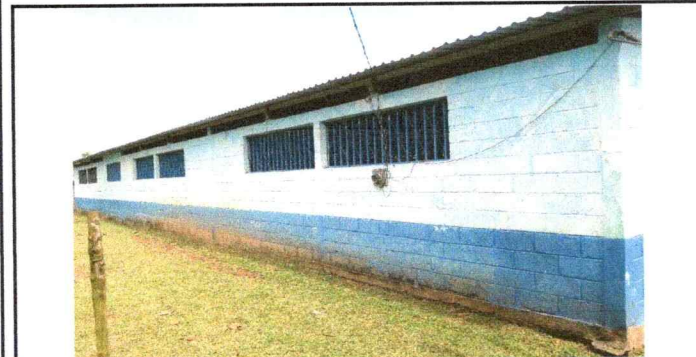
Foto 5: Se observa pintura deteriorada.
