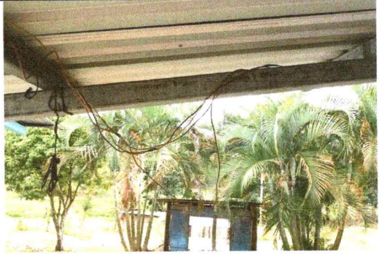
Foto 14: Se observa cableado eléctrico expuesto.
