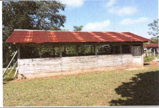
Foto 2: Se observa techo en mal estado.
