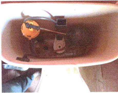
Foto 15: Se observa accesorios de sanitarios en mal estado.
