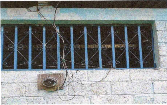
Foto13: Se observa cableado eléctrico desorganizado.
